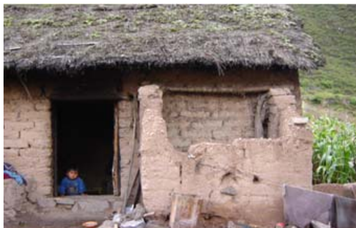
Figura 17. El acceso al agua potable es muy deficiente para las poblaciones rurales de Bolivia, las que incrementarían su déficit bajo condiciones de cambio climático. Foto: NCAP,2006
